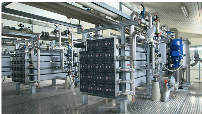
Nanofiltreringsanlegg for avherding og sporstoffjerning
