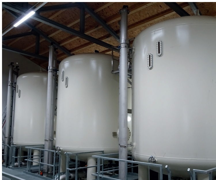
Hurtigfilteranlegg for avjerning og fjerning av mangan
