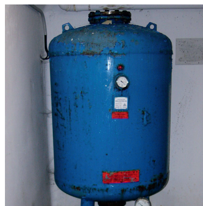
Fig.2: Korrosjon og rust
