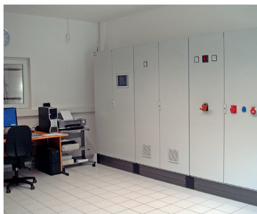
Sentralen i et vannverk
