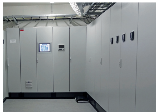
Kontrollskap i et vannverk
