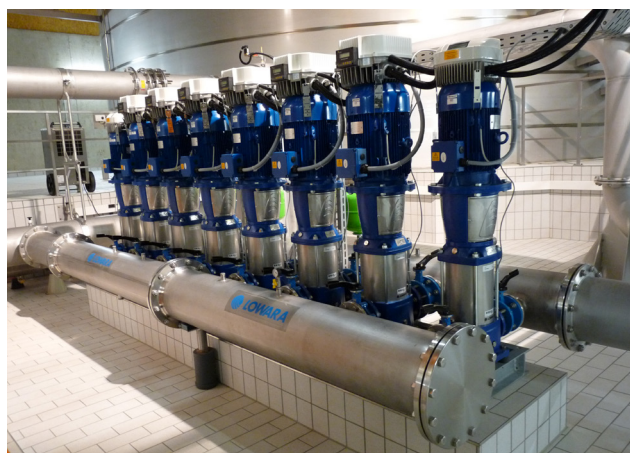
Trykkøkningsanlegg med frekvensomformere
